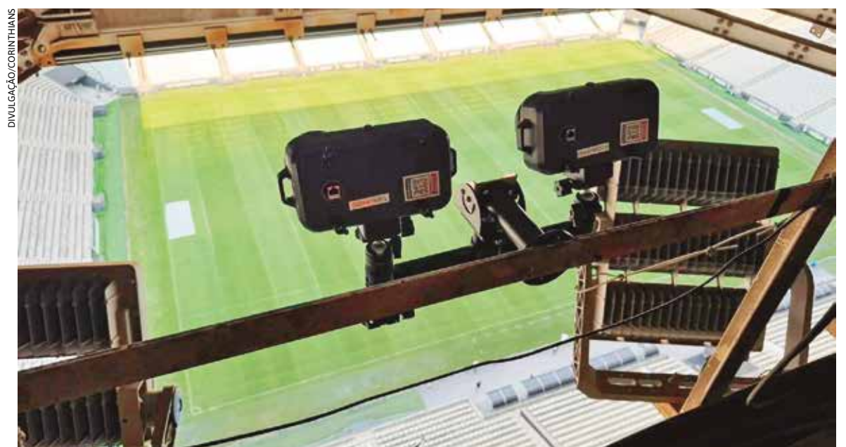
Câmeras instaladas na Neo Química Arena para a implementação do SAOT
