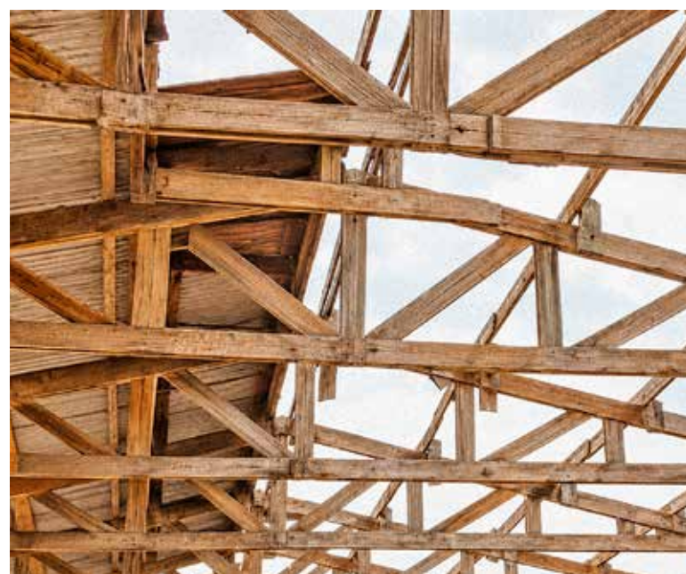
Vítima realizava manutenção no telhado de um galpão
