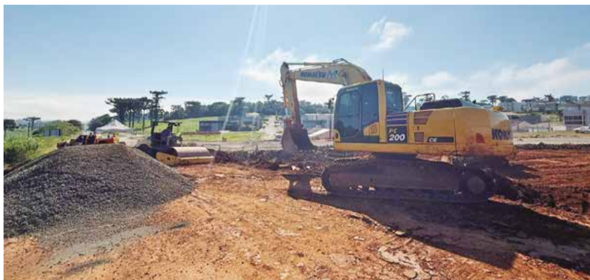
Intervenção de grande porte em frente ao Loteamento Dona Olga amplia sistema de drenagem e prepara a cidade para enfrentar eventos climáticos extremos
