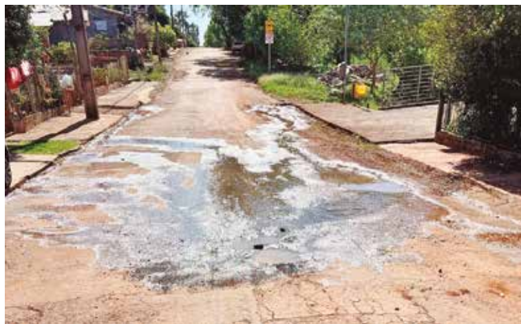
Vazamentos causam transtornos em diversos pontos da cidade
